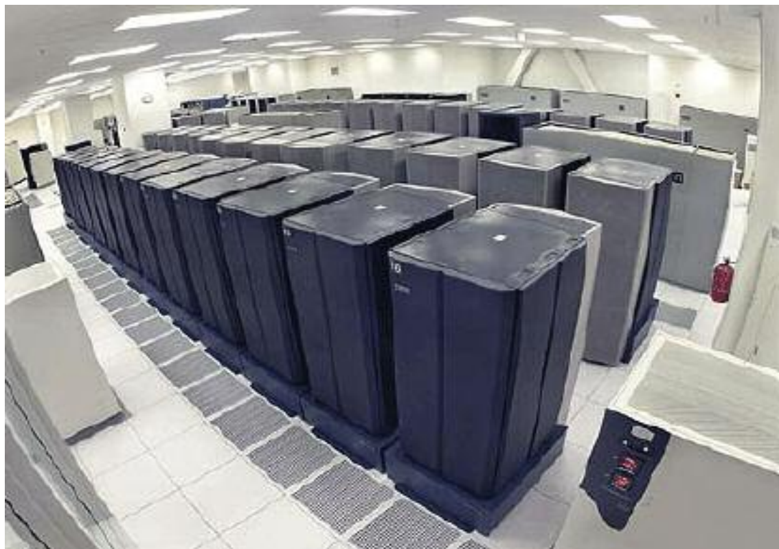
Una sala server
